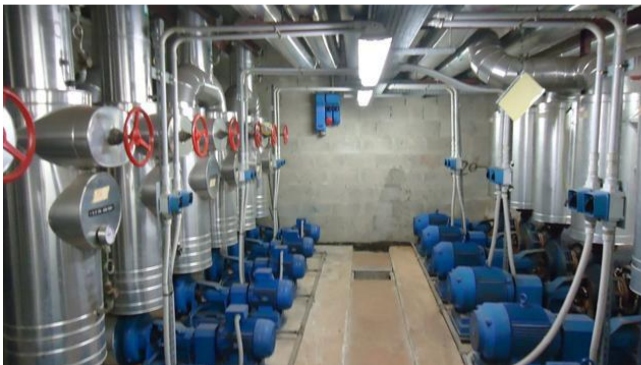
UNA CENTRALE TERMICA ( FOTO 9)
