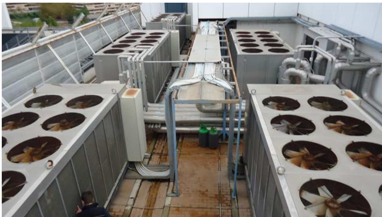
GRUPPI FRIGO DA SOSTITUIRE CORPO "B" ( FOTO 6)
