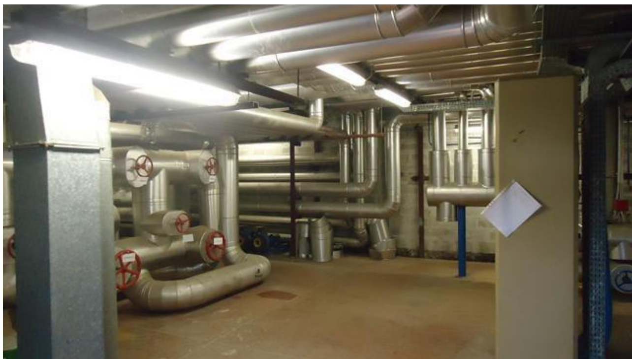
UNA CENTRALE FRIGORIFERA ( FOTO 8)
