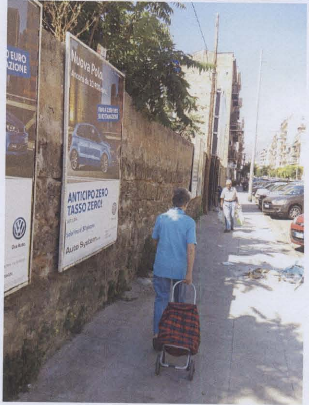
Muro tipo B – foto B2
