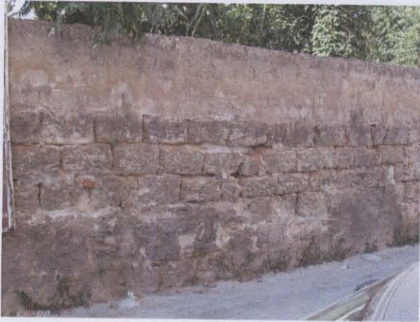
Muro tipo B – foto B1
