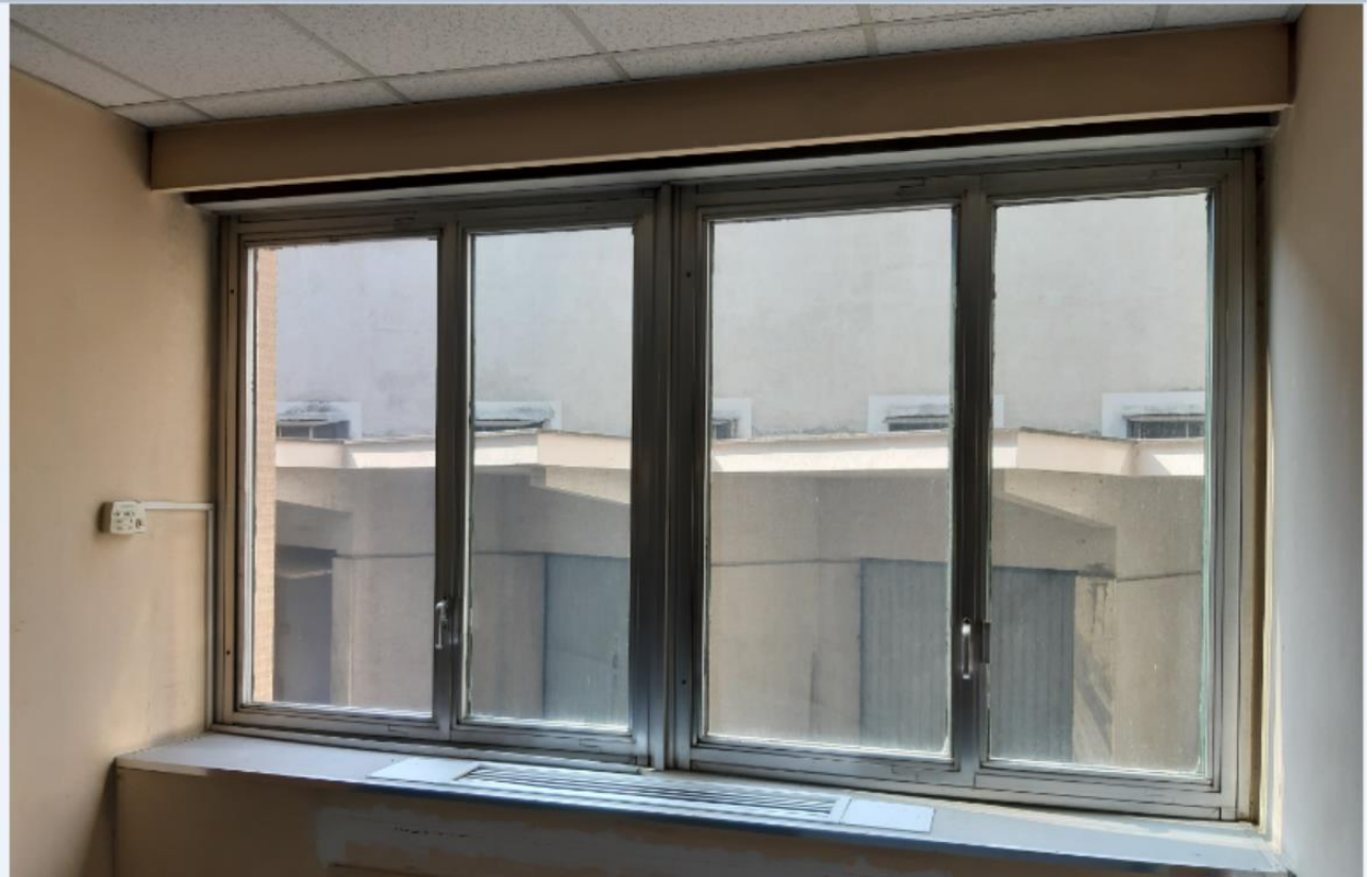
Finestre piano terra da sostituire su entrambi i piani
