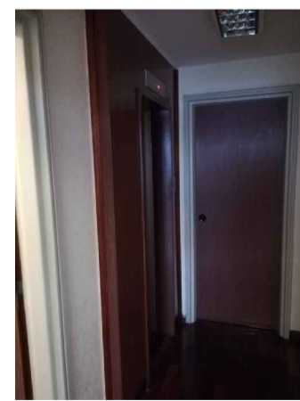
Vano porta ascensore E e placcatura in formica da eliminare e rifinire
