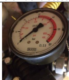
Manometro pompa di compensazione
