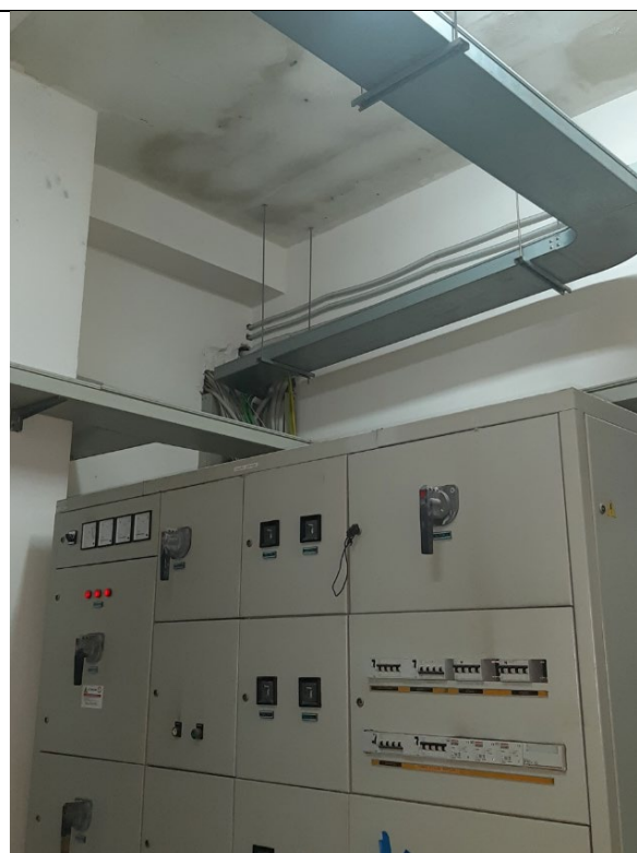
Foto 02 - dell'attuale locale quadri elettrici (allegato 25) di piano interrato dove si evince la vetusta dei quadri elettrici con interruttori che non garantiscono le protezioni adeguati e gli attraversamenti di canali e tubi tra ambienti diversi senza l'adeguata protezione passiva
