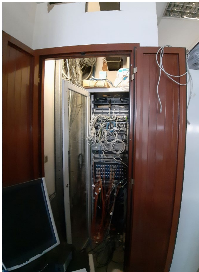
Foto 04 - Condizione dei locali RAK di piano che attualmente hanno accesso diretto dai locali archivi tipo A di piano con una semplice porta in alluminio che normalmente è sempre aperta e con un computer collocato nel locale archivio e collegato al quadro RAK
