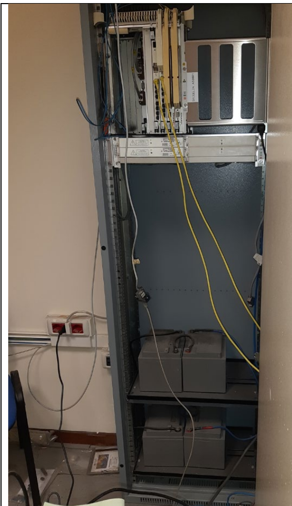
Foto 03 - scattata al piano II, nel locale dove è collocato l'attuale centro RAK le condizioni degli impianti e delle apparecchiature presenti sono tali da poter essere le stesse rischio d'incendio
