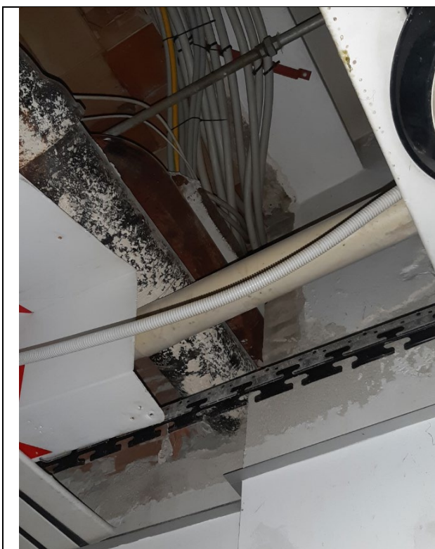
Foto 01 - con rappresentazione di cavi che passano dalla zona bagni di piano interrato al piano rialzato
