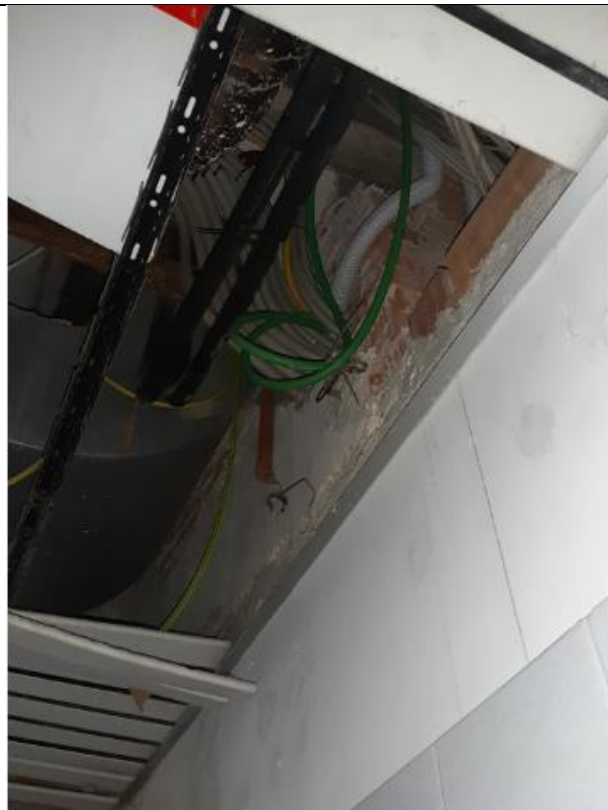
Foto 35- con risalita cavi verso i quadri di piano e controsoffitto presente al piano interrato da dismettere, siccome la parete senza intonaco confina con l'archivio b, la stessa sarà soggetta ad interventi di adeguamento che ne consenta la giusta compartimentazione dai locali confinanti
