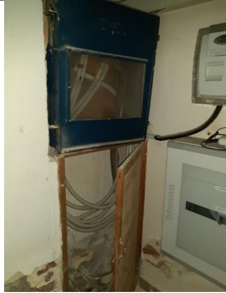
Foto 26 - con punto consegna, misuratore di energia e quadro elettrico Q02 alimentazione quadro gruppi di pressurizzazione antincendio da dismettere, nelle lavorazioni è prevista la richiesta alla società fornitrice di energia per la messa a norma del punto di consegna (morsettiera con bulloni di manovra isolati)
