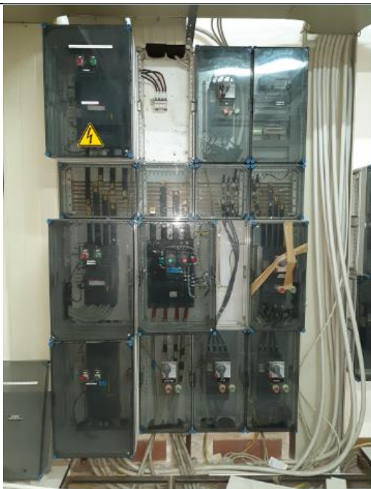
Foto 31 - Quadro Q04, arrivo linea dal quadro Q01 da dismettere
