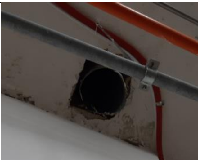
Foto 15 - con intervento soluzione D, particolare G
