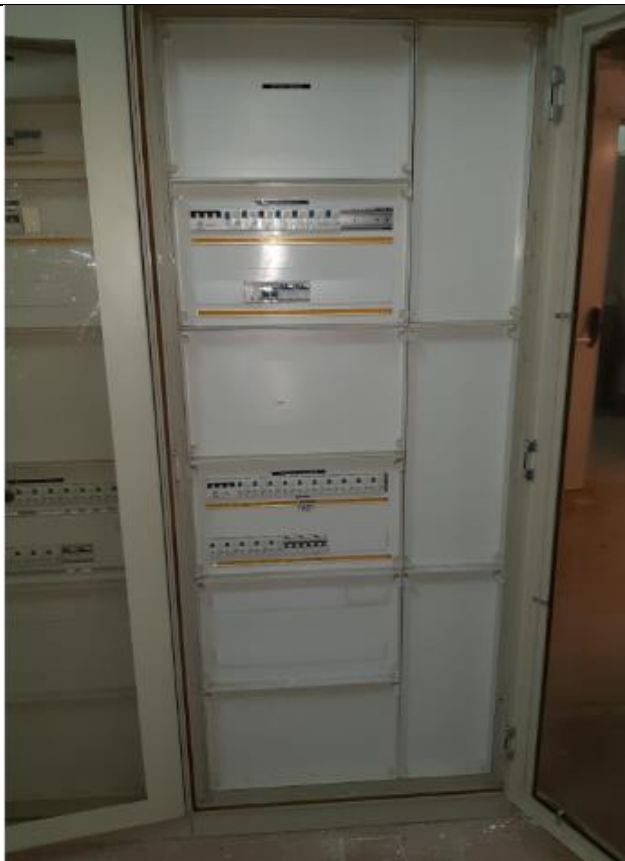
Foto 33 - Q06 lato DX, da dismettere
