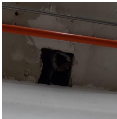
Foto 12 - con intervento soluzione D , particolare G
