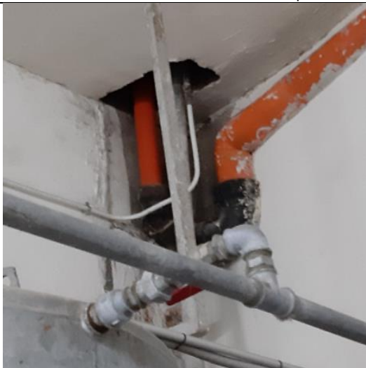
Foto 23 - con intervento soluzione D - A - B e C, particolare G
