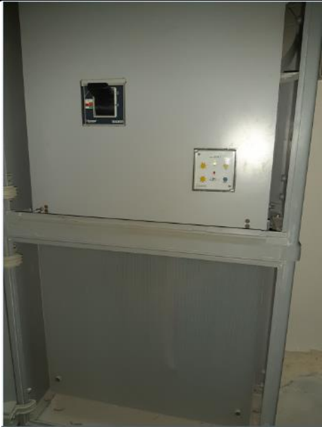
Foto 27 - con quadro contatore Q01 – da dismettere
