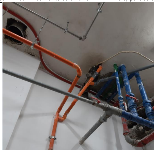
Foto 16 - con intervento soluzione D - B e C, particolare G
