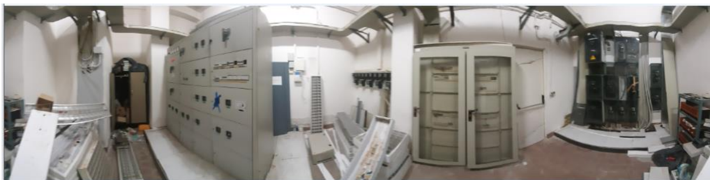
Foto 34 - Vista d'insieme del locale quadri elettrici di distribuzione, partendo da SX verso DX abbiamo il quadro Q05, il quadro Q06 e il quadro Q04, nella foto è visibile anche la canalizzazione e i cavi che dovranno essere smontati e dismessi. Al termine dei lavori di dismissione il locale dovrà essere lasciato sgombro da qualsiasi materiale e nello stesso si dovrà provvedere a rifare il pavimento ed a risanare l'intonaco ammalorato.
