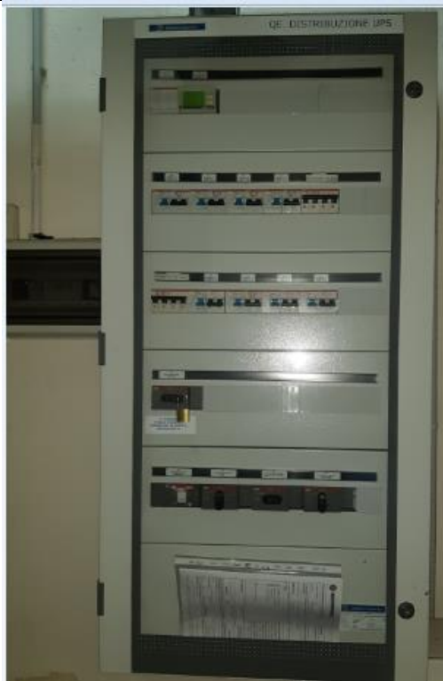
Foto 29 - Quadro UPS Q18 che rimane, centralino Q22 da dismettere
