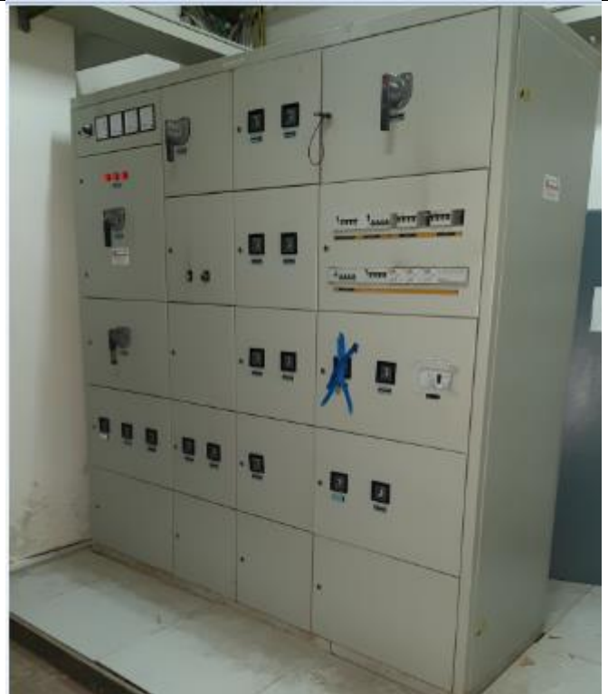
Foto 30 - Quadro di distribuzione generale Q05 da dismettere
