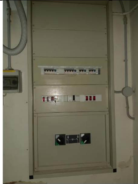
Foto 28 - Quadro commutazione Q20 da dismettere e centralino Q21
